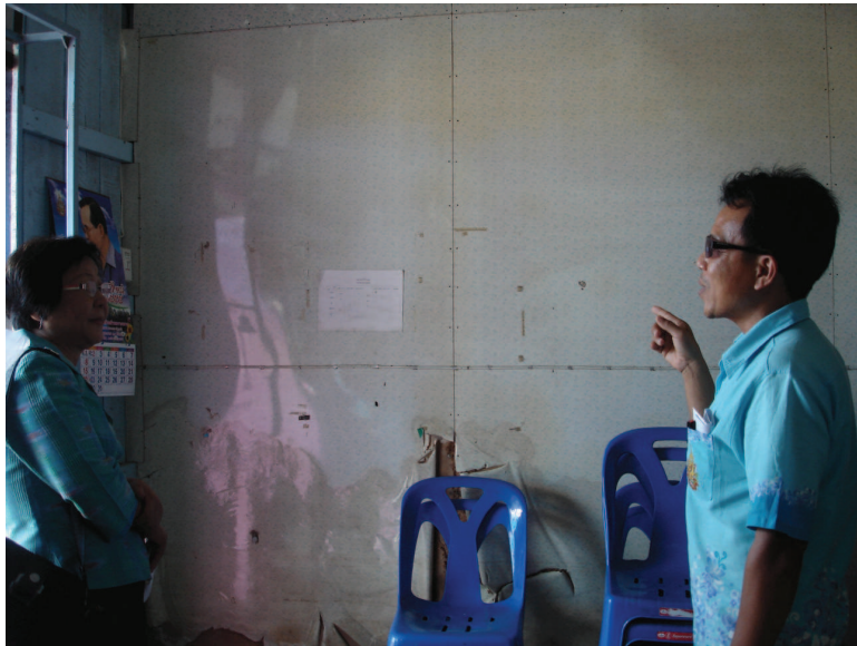
สภาพผนังห้องสมุด โรงเรียนก่อนการลงสี
